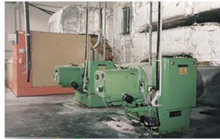
Vieja estación de aire comprimido: alto consumo de energía
