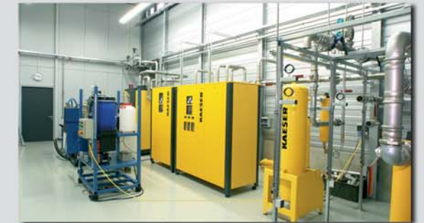
Instalaciones de alta tecnología para poner a prueba los nuevos productos
